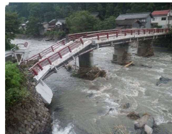
鳥取市佐治町高山橋(橋梁の崩落)
